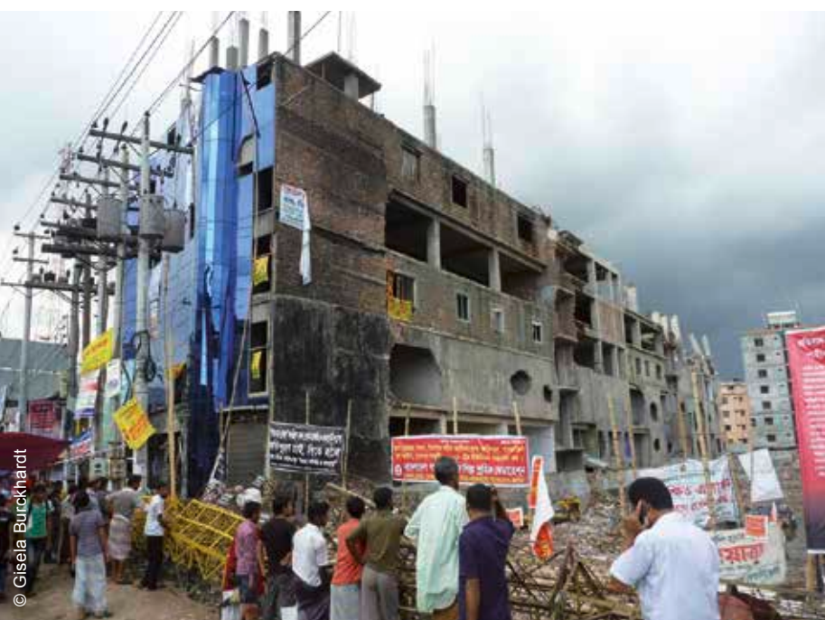
Die Reste des Rana Plaza-Gebäudes 2014
